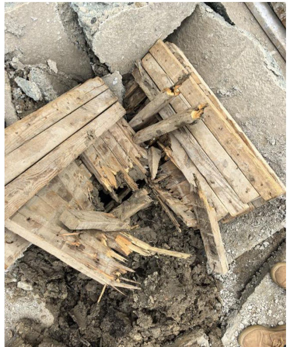
图 4 支座受力破坏后的状态
