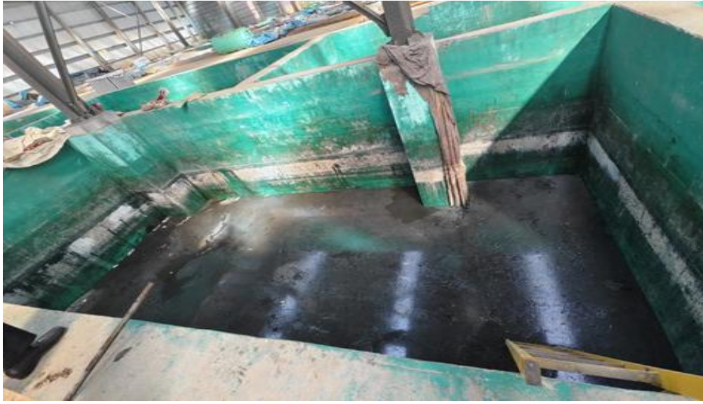
图 5 车间事故腌渍池影像图
